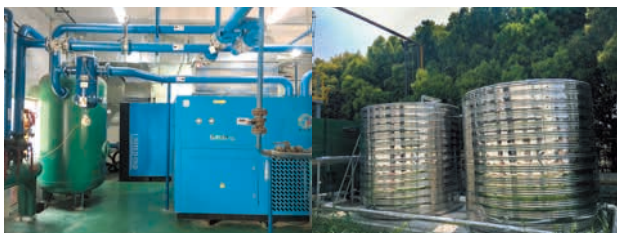
インバータコンプレッサ(200kW) 1台 余熱回収→保温水タンク 2台
